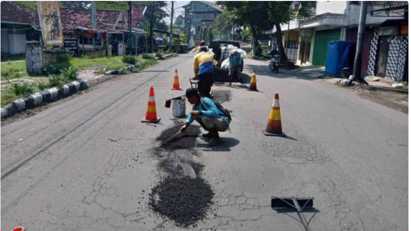
Dinas PUPR Kota Kediri menambal jalan berlubang di sepanjang Jalan Merbabu Mrican
